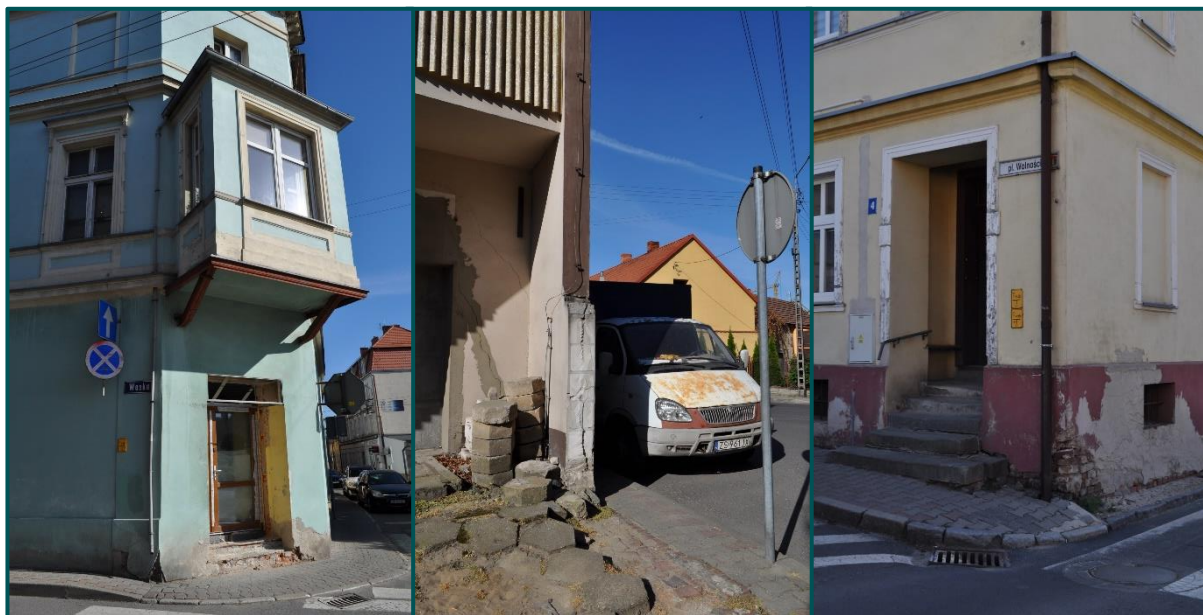
Rysunek 12. Stan i jakość chodników na terenie centrum Żmigrodu.
