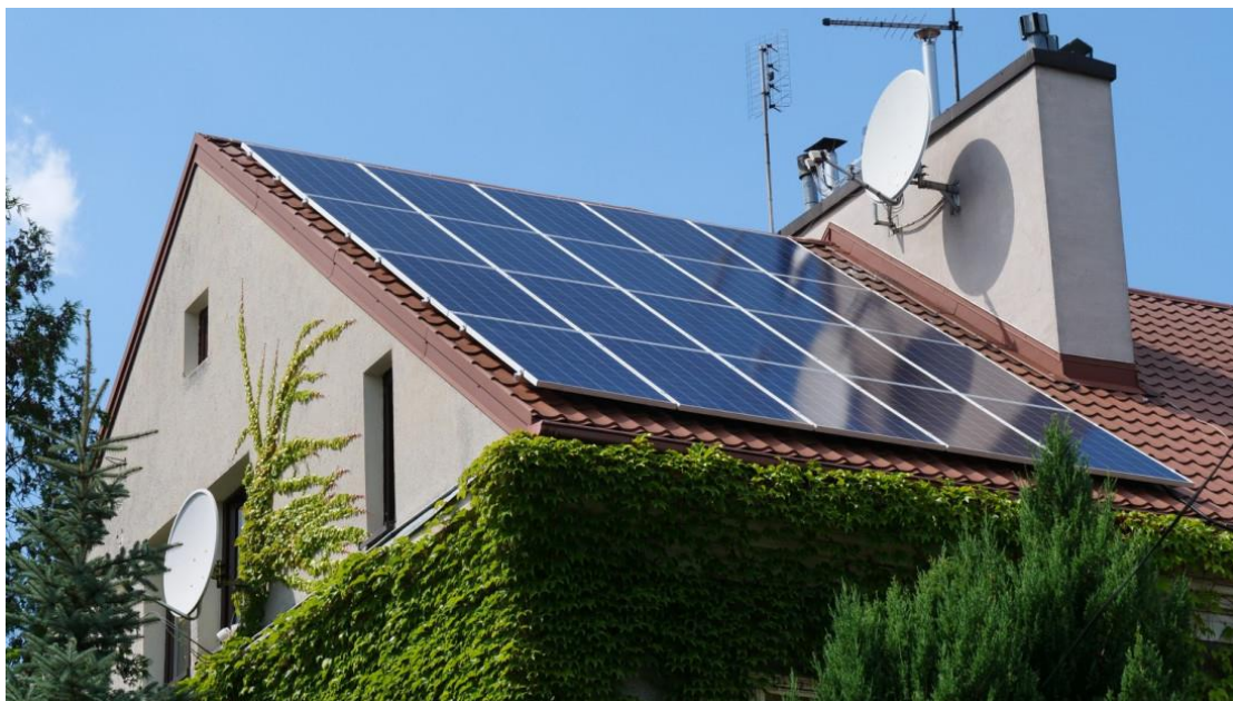
Rysunek 8. Przykładowa instalacja fotowoltaiczna (źródło: https://budujemydom.pl )
